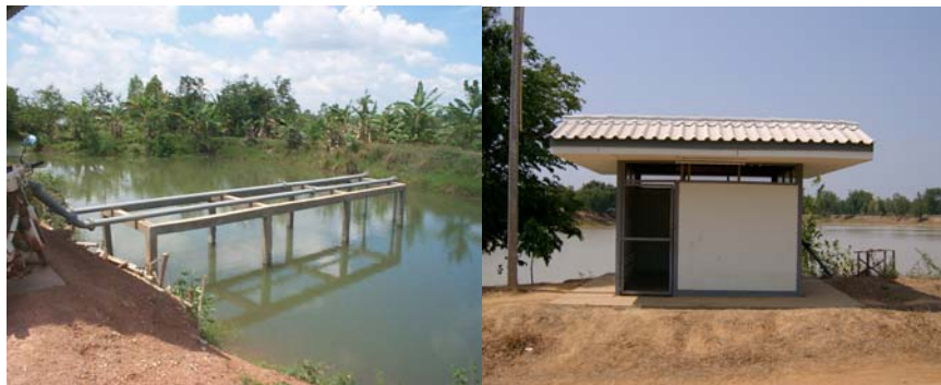
รูปที่ 23 -24 (จากซ้ายไปขวา) ท่อส่งน้ำดิบระบบประปาแบบผิวดิน และ โรงสูบน้ำดิบ
